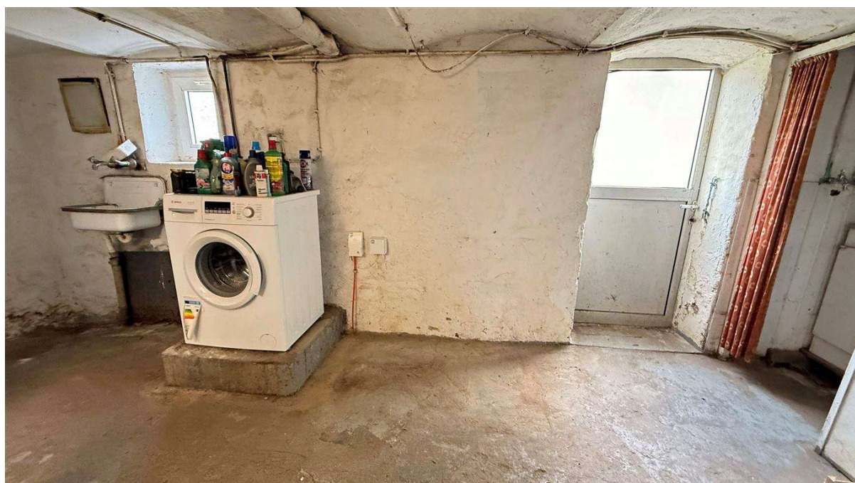
Vollkeller. Glasfaseranschluß im Haus (neben Waschmaschine)!
