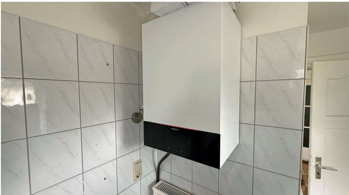
...eigener Heizung (moderne Erdgas-Therme)
