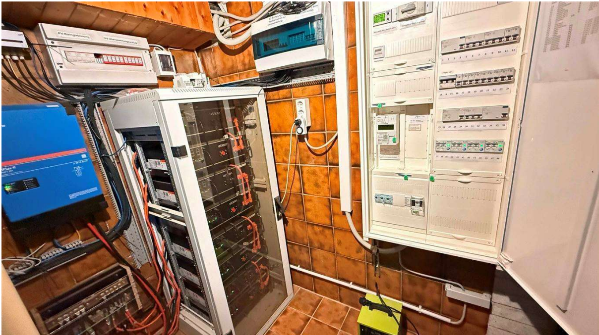
PV-Anlage 10 kWh mit Stromspeicher 24 kWh
