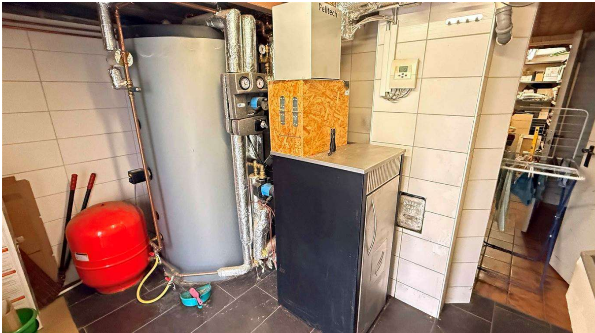
...und 800 L Pufferspeicher mit Elektro-Heizstab
