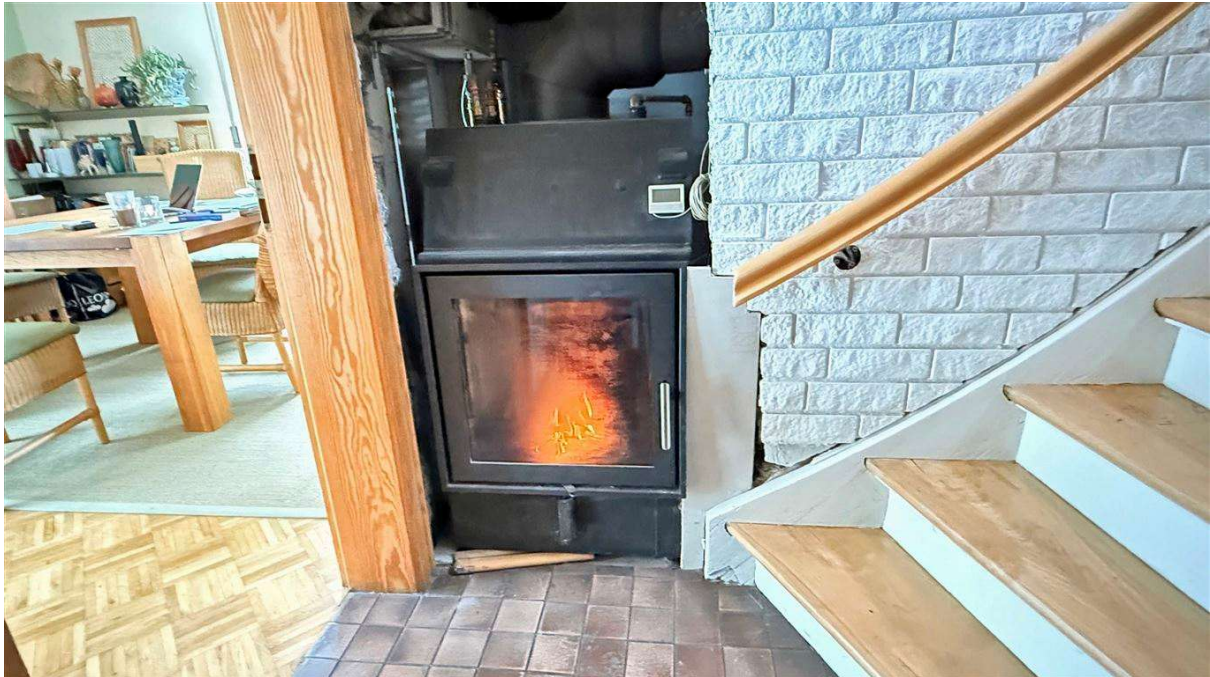
wasserführender Kaminofen als 2. Zentralheizung
