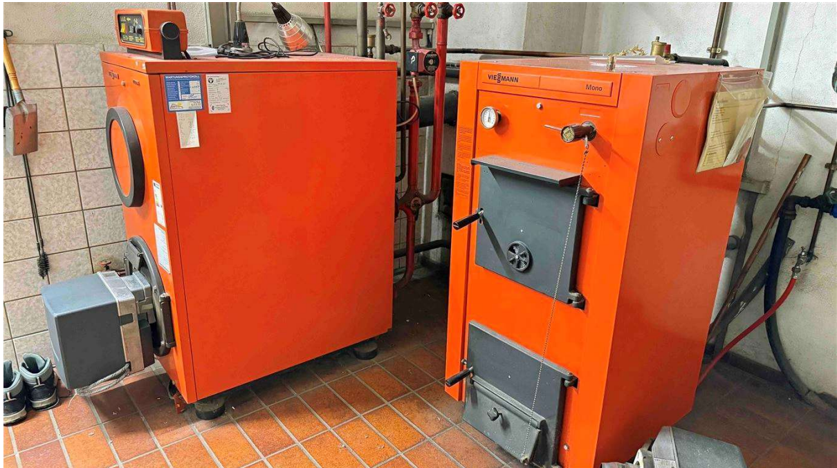
2 Heizungen Hauptwng.: Öl oder Holz Baujahr81
