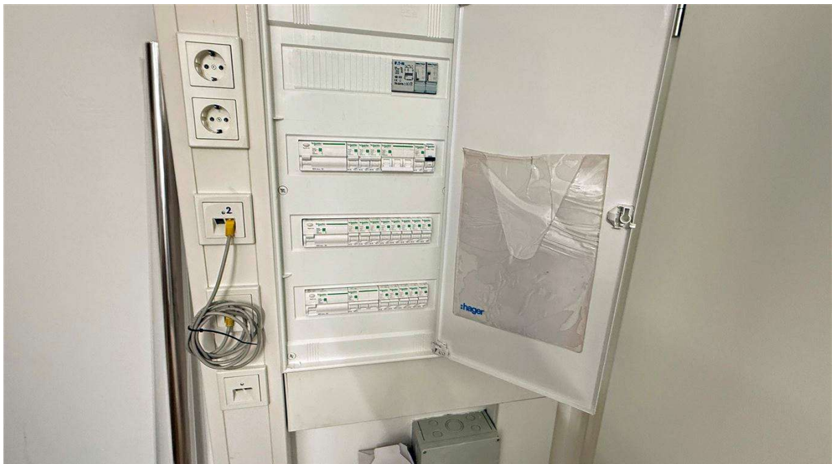
schnelles Internet (Glasfaserleitung)
