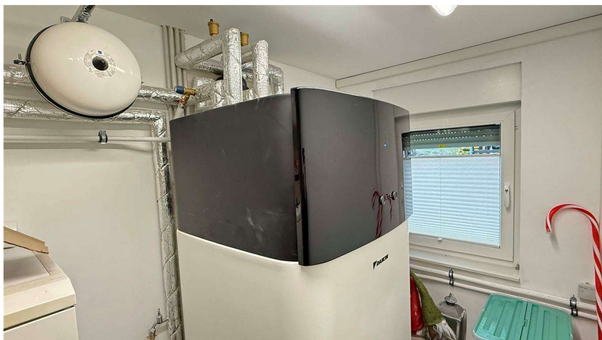
Heizung Einliegerwohnung: Wärmepumpe Baujahr 2022 als FB-Heizung
