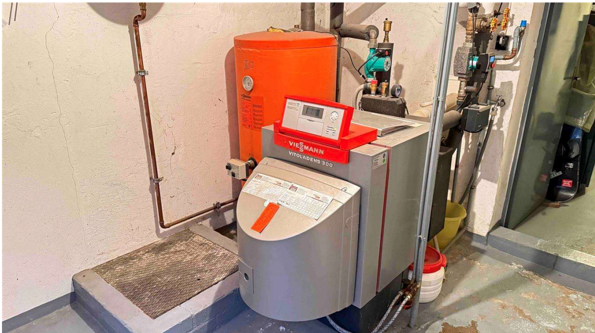
moderne Öl-Zentralheizung Baujahr 2010 (Brennwert)
