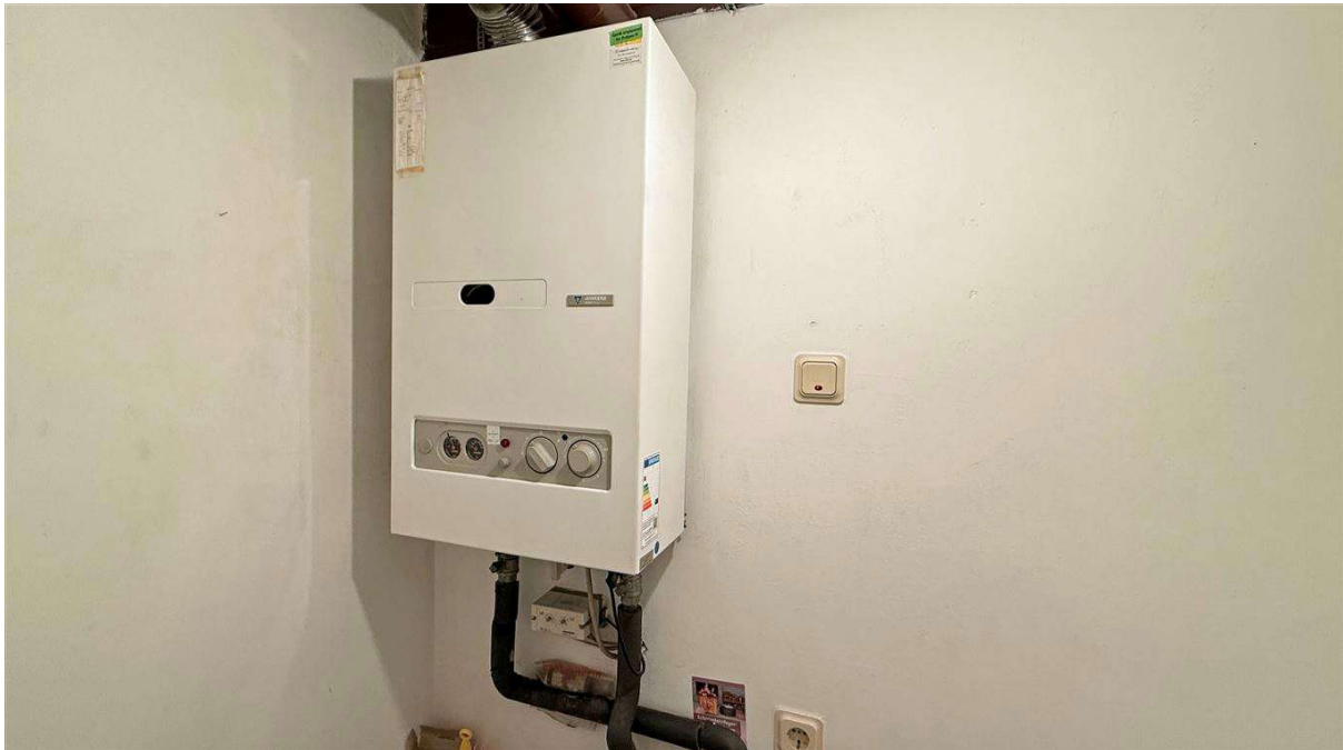
eigene (Etagen-) Gasheizung, Baujahr 1991, als ...
