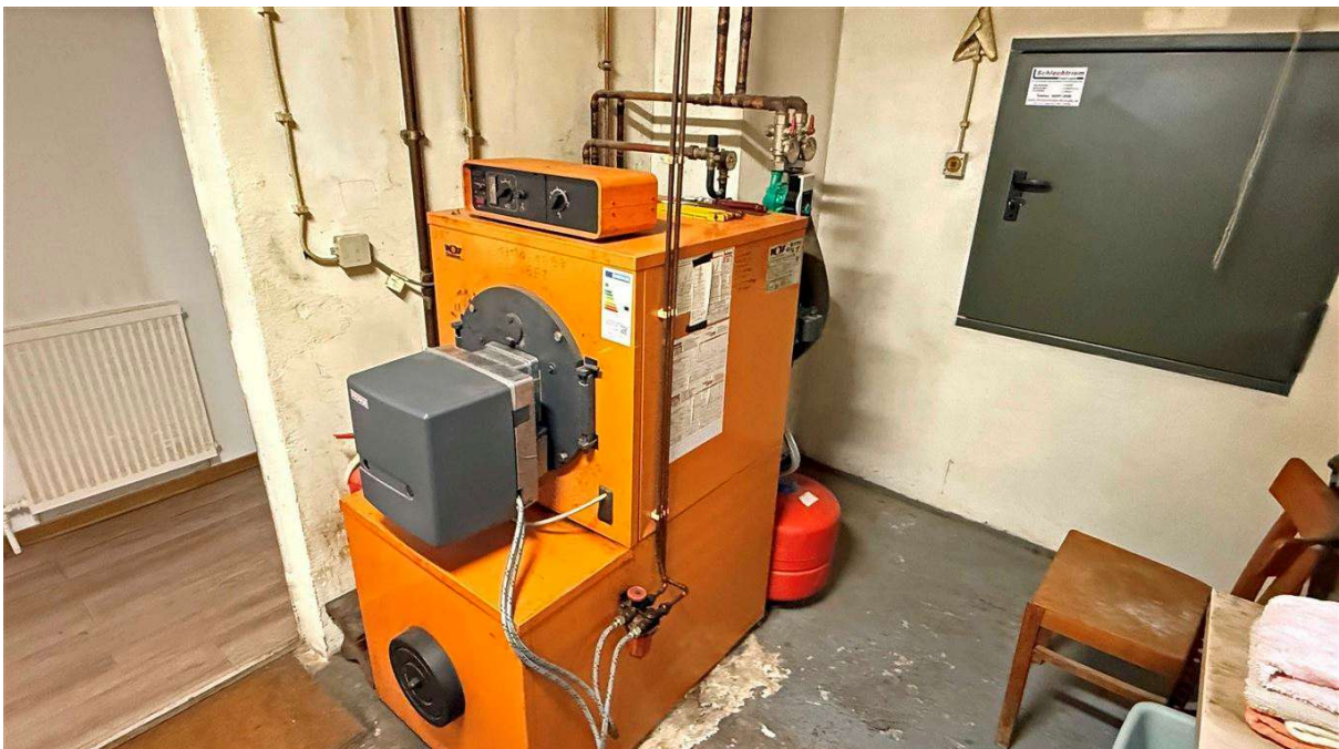
Öl-Zentralheizung, Baujahr 1994 / Brenner 2017 neu
