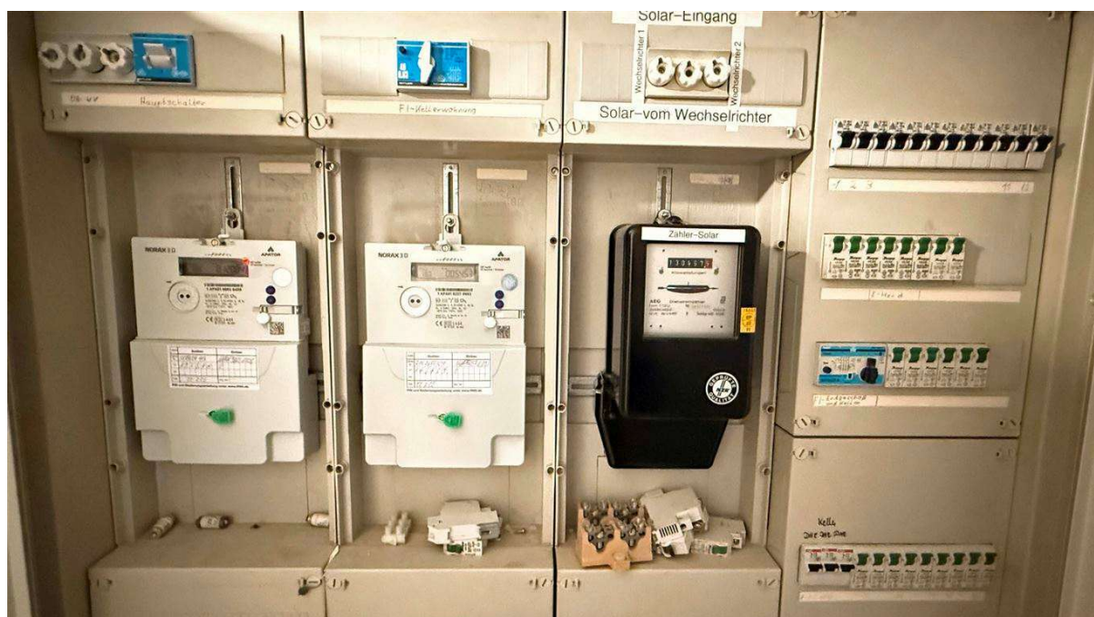
Separate Zähler für Strom, Wasser und Heizung
