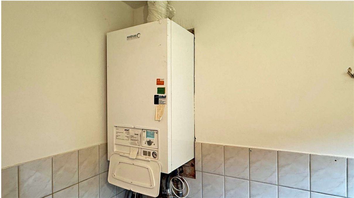
Heizung: moderne Gastherme Baujahr 2017
