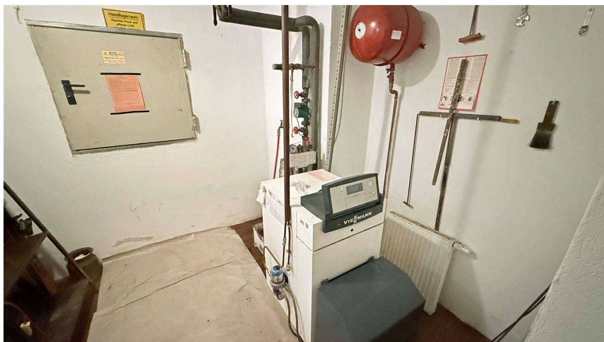
Ölheizung Baujahr 2003 (inkl. Schornsteinsanierung)
