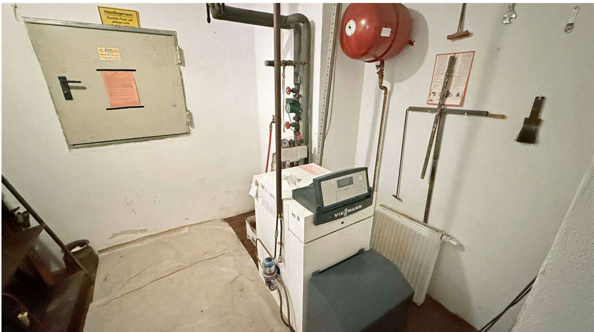
Ölheizung Baujahr 2003 (inkl. Schornsteinsanierung)
