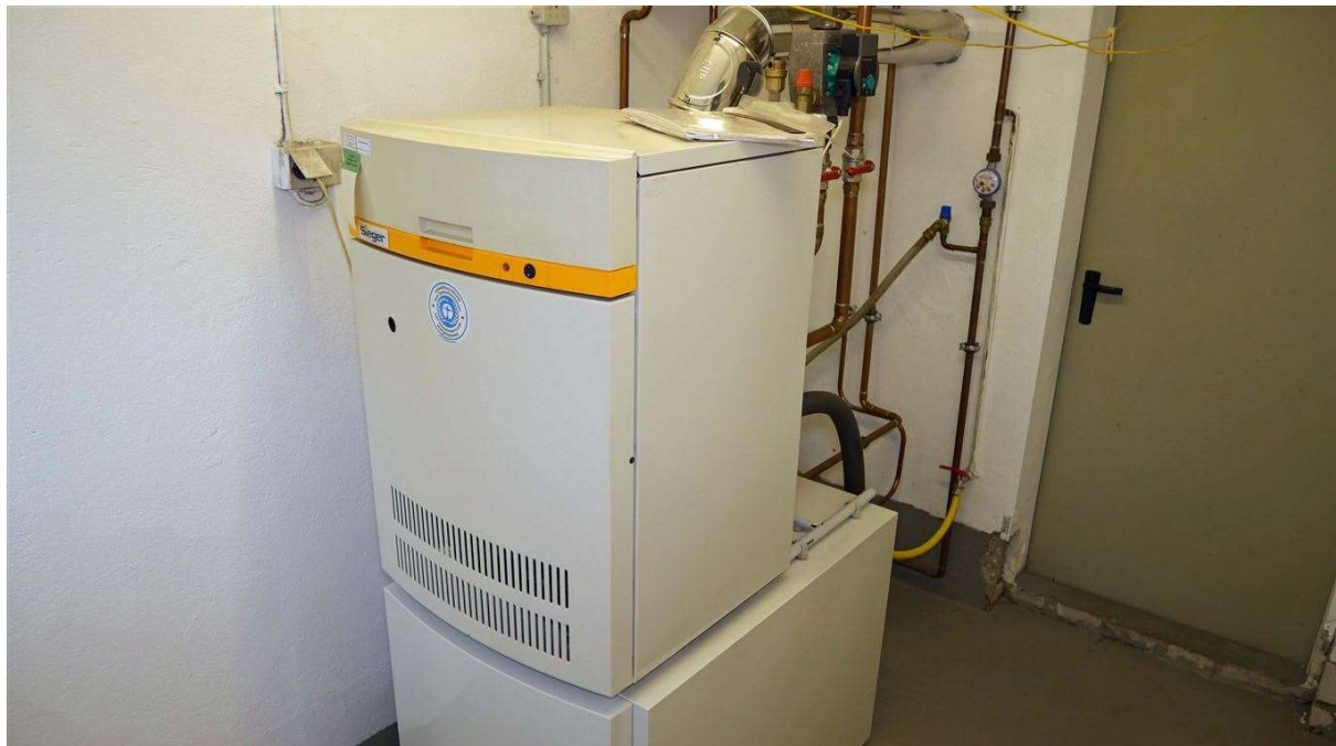
Gasheizung mit Brauchwasser, Baujahr 1999
