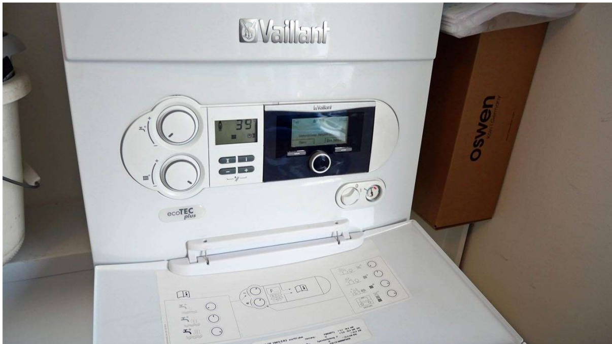
modernste Heiztechnik: Gas-Brennwert, Baujahr 2013
