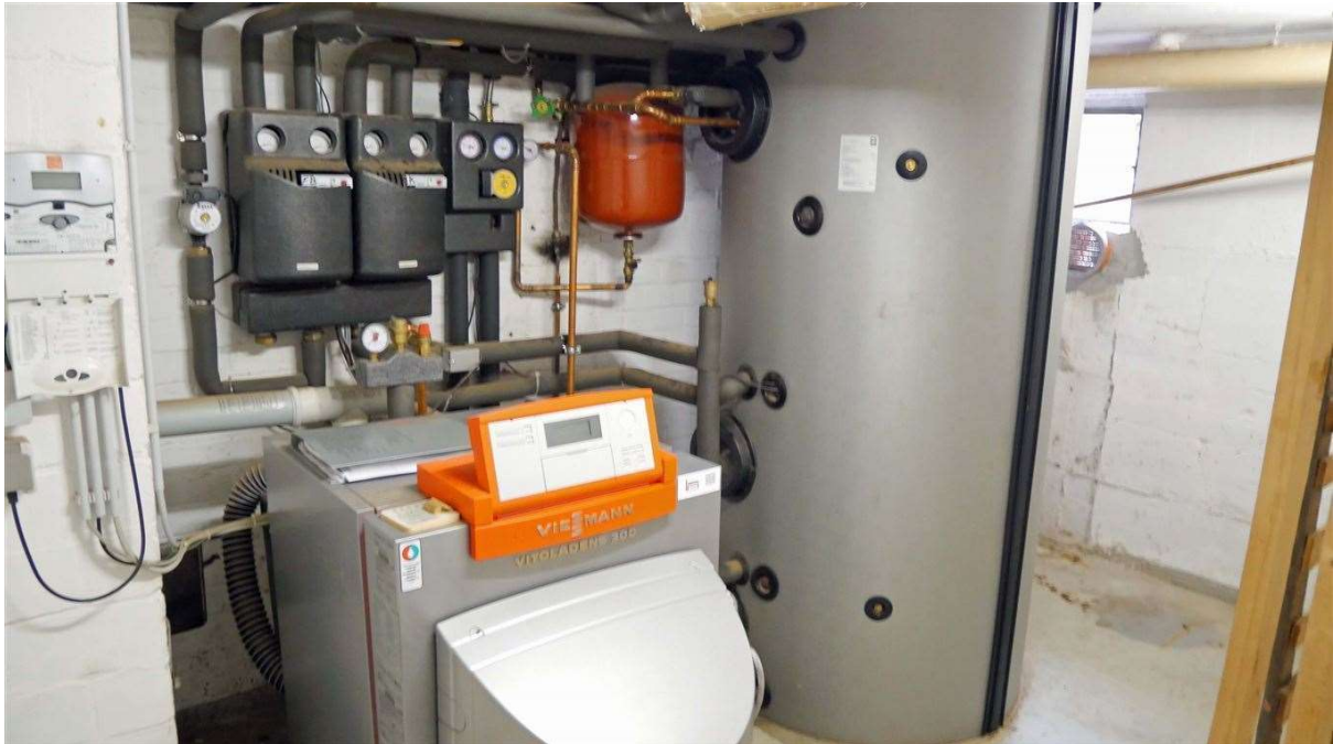
moderne Öl-Brennwert-Heizung, Baujahr 2008 mit Solar
