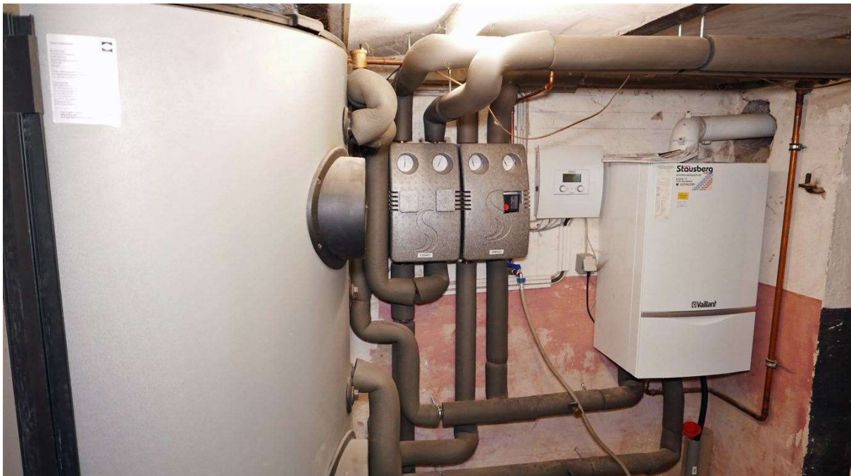
modernste Heiztechnik (Brennwert + Kachelofen)
