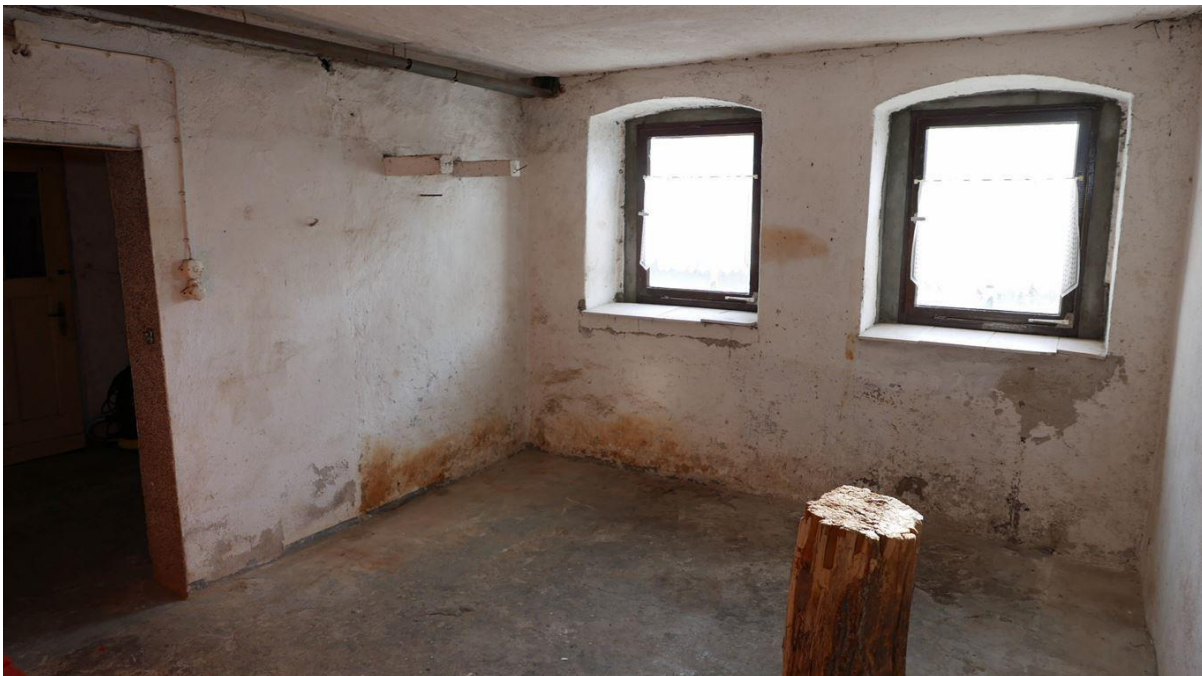
...und 19 m 2 großem Heizraum mit viel Tageslicht
