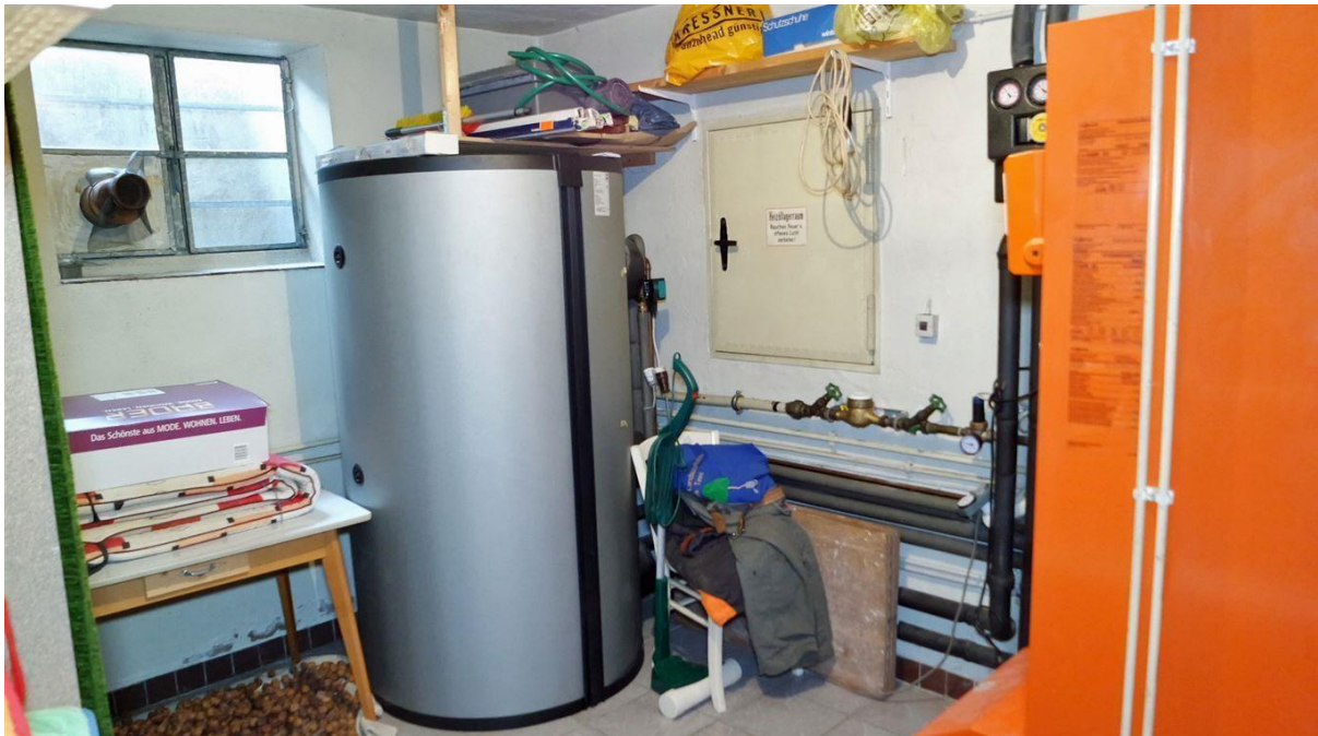
...Pufferspeicher und Solaranlage auf dem Dach
