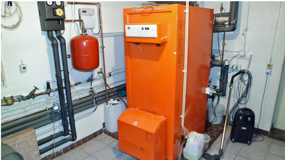
Ölheizung, Baujahr 1999 mit...
