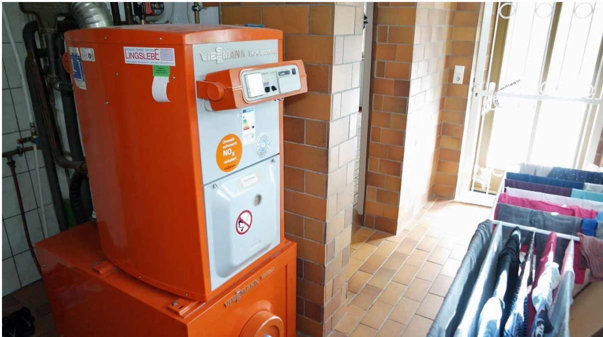
Erdgas-Zentralheizung mit WW, Baujahr 1991
