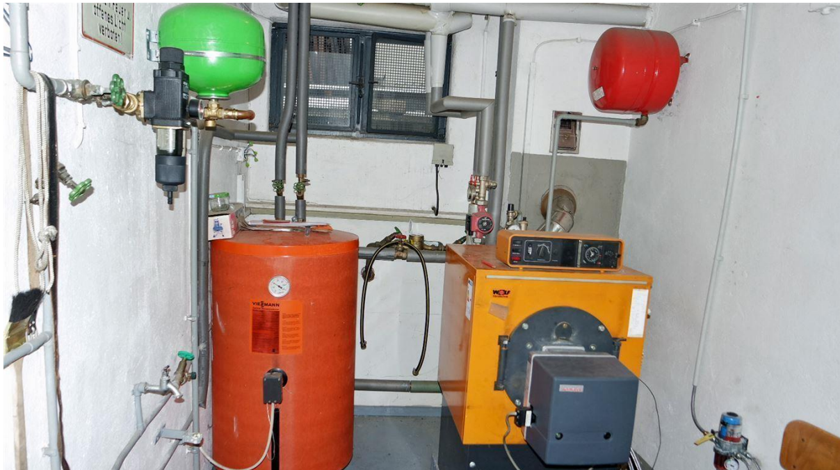
Öl-Heizung, Baujahr 1989 mit neuem Brenner
