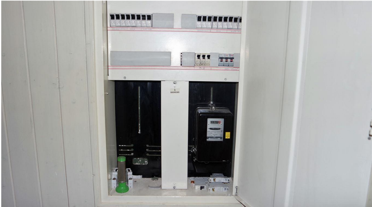
Zweiter, separater Stromzähler für die Einliegerwohnung möglich
