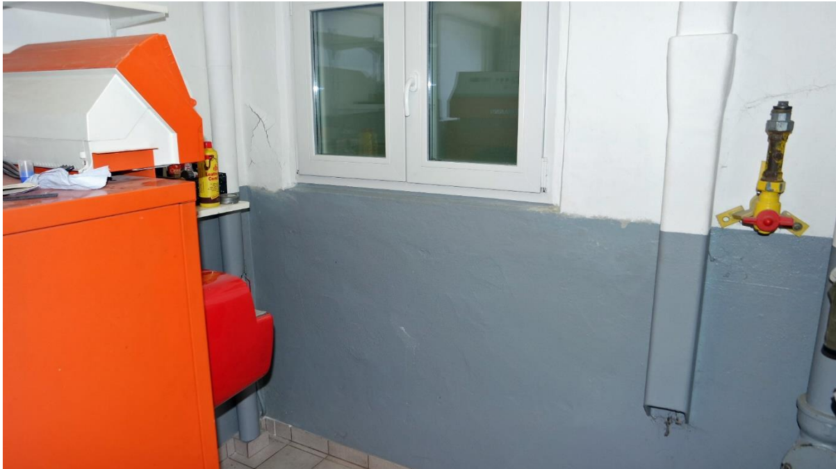
Öl-Zentralheizung Baujahr 1980, Erdgasanschluß daneben
