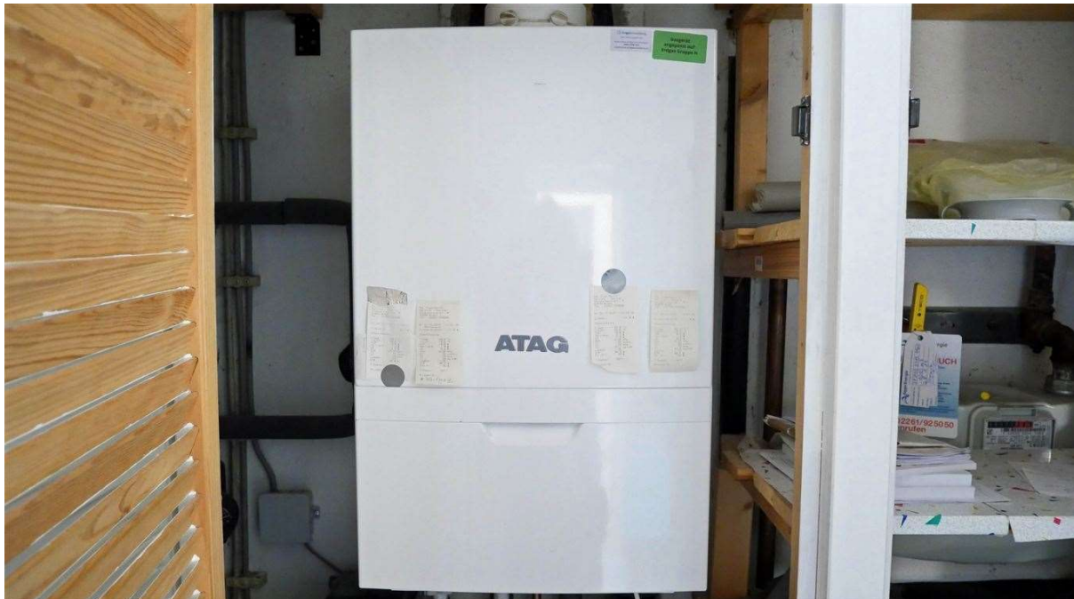
moderne Erdgas- Brennwertheizung Baujahr 2017
